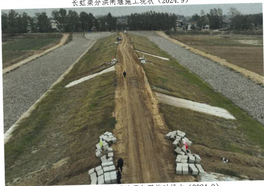
长虹渠分洪闸堰施工道路需加强临时排水（2024.9）
