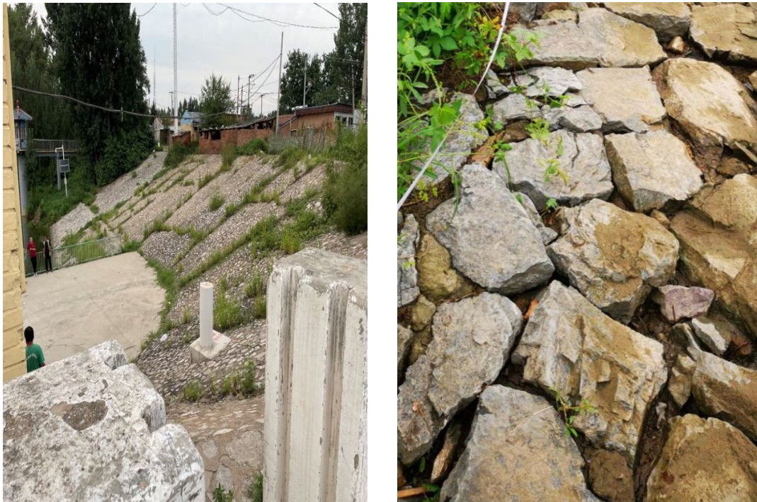
图 3.2.1-14 牛牧屯防洪引水闸上游左、右岸浆砌石现状
