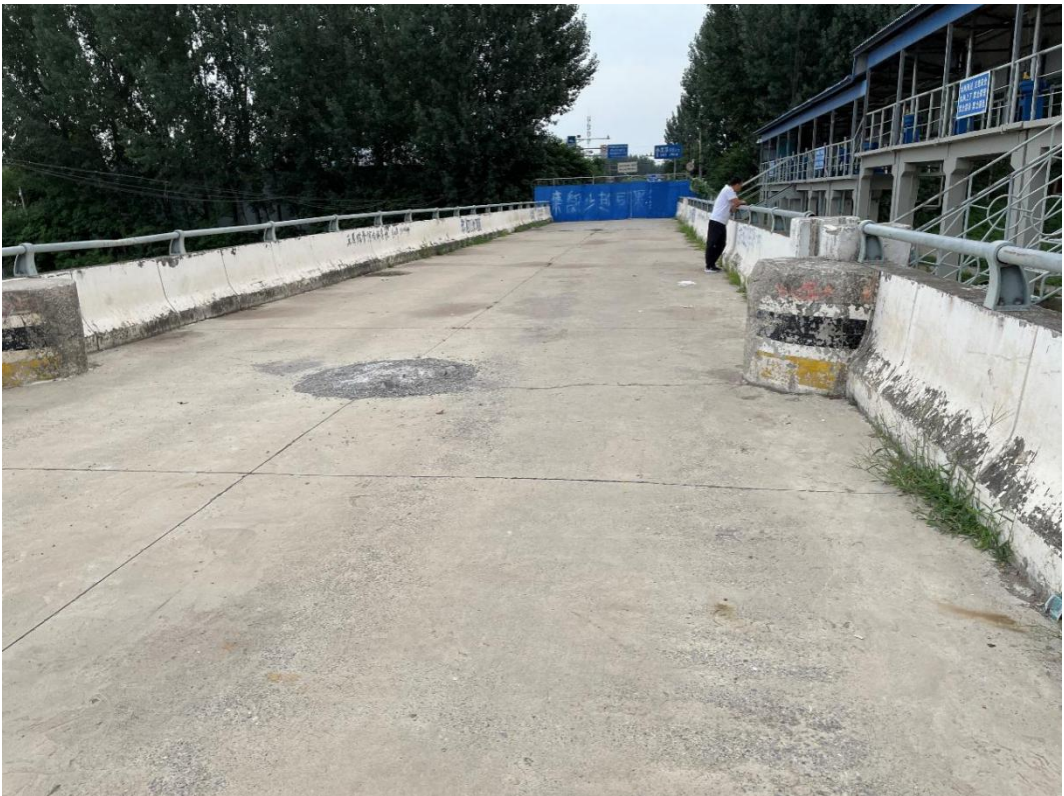
图 3.2.1-12 牛牧屯防洪引水闸路面现状
