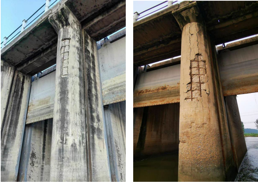
图 3.2.1-4 吴村节制闸桥墩混凝土剥落，钢筋锈蚀
