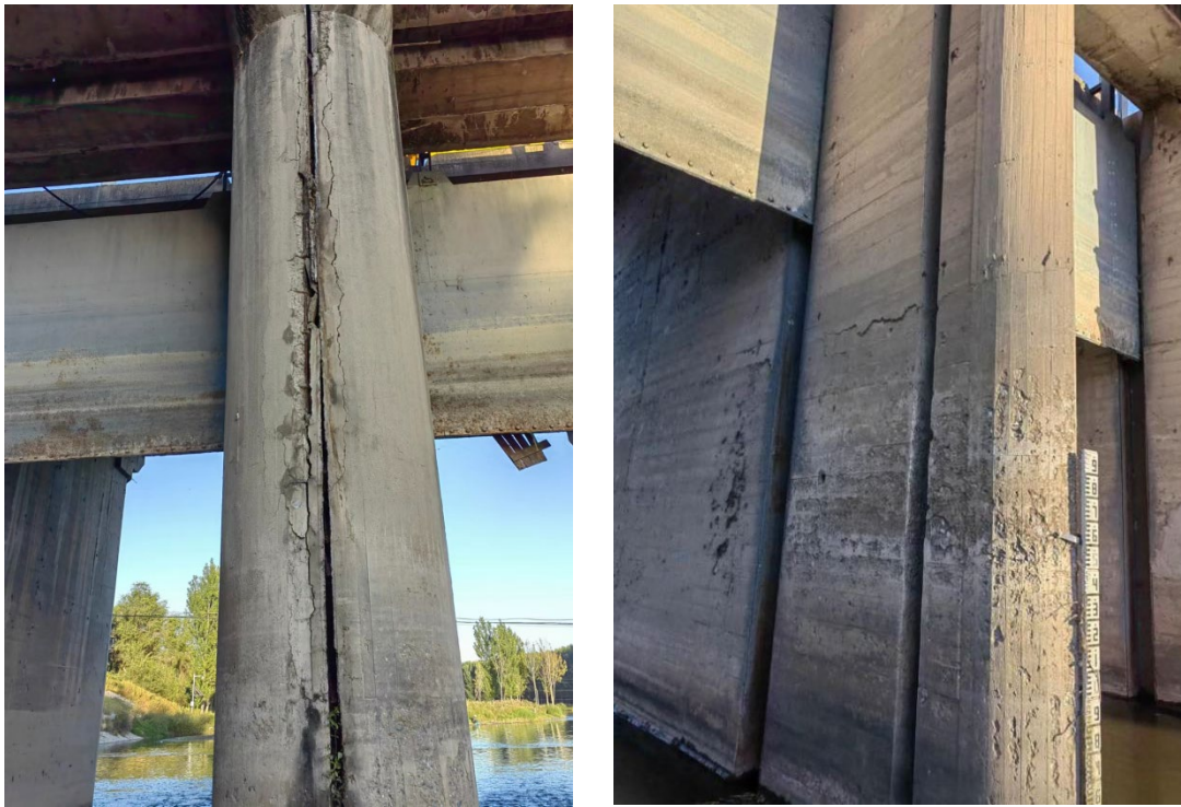
图 3.2.1-5 吴村节制闸桥墩混凝土裂缝、剥蚀
