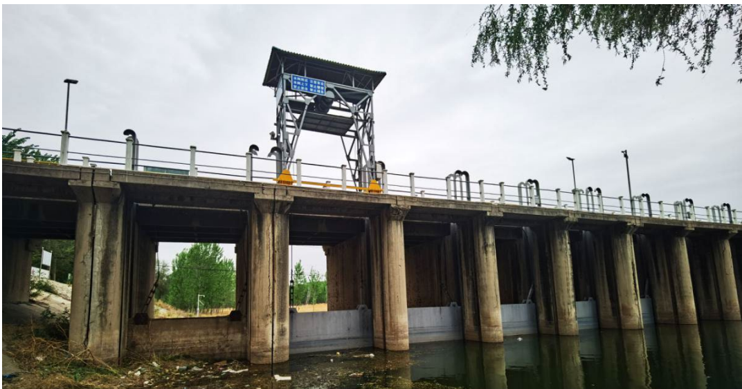
图 3.2.1-3 吴村节制闸闸墩裂缝
