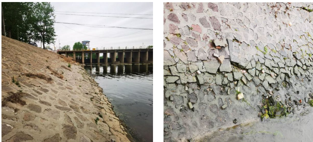
图 3.2.1-8 下游浆砌石破损
